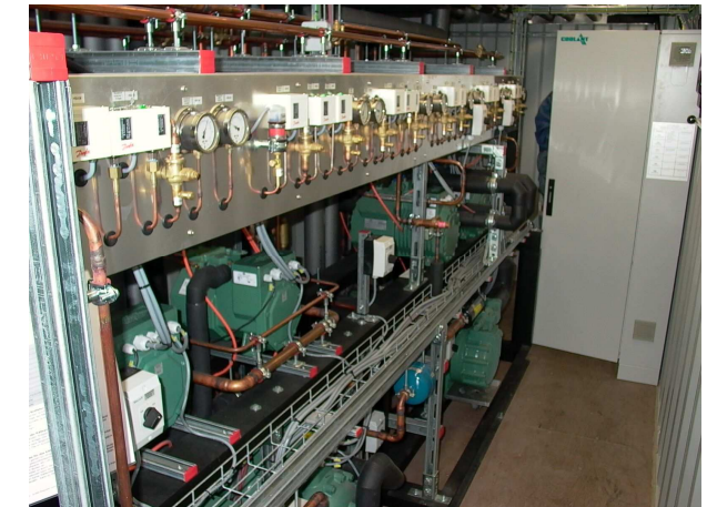
COOLANT®-Kältemaschinensatz mit halbhermetischen Bitzer®- Kältemaschinen DANFOSS®- Armaturen und SIEMENS®- Schaltschranktechnik
